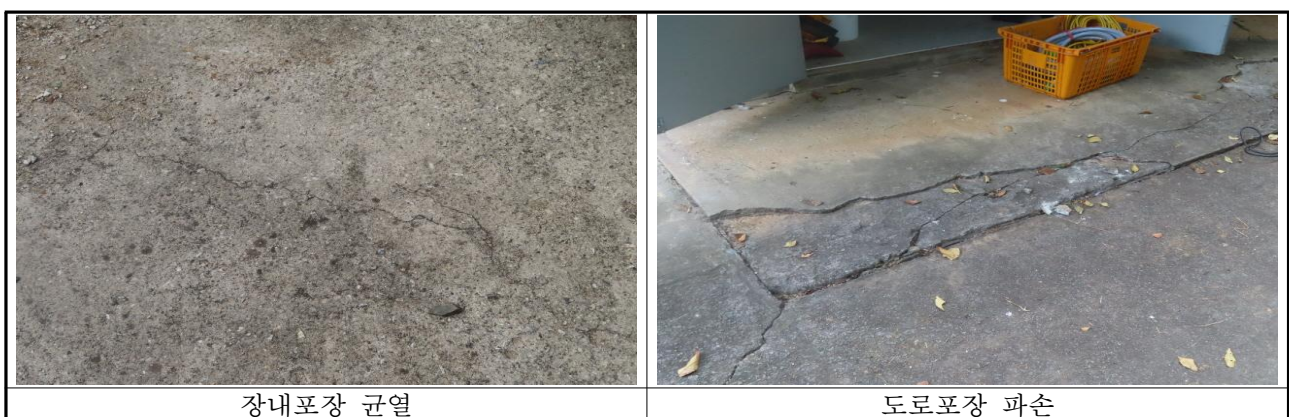
【사진 3.12】 도로포장 손상사진
