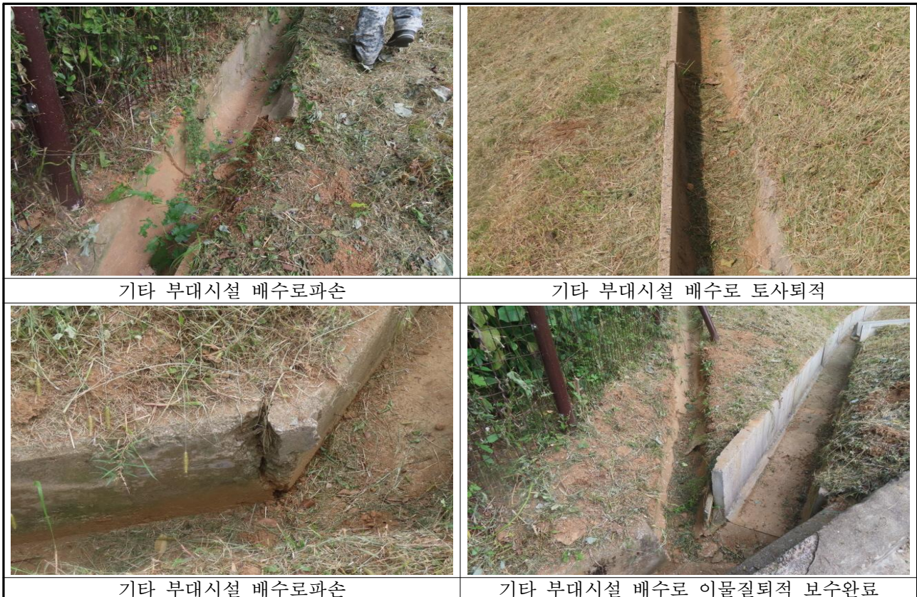
【사진 3.9】 기타 부대시설 손상사진(계속)
