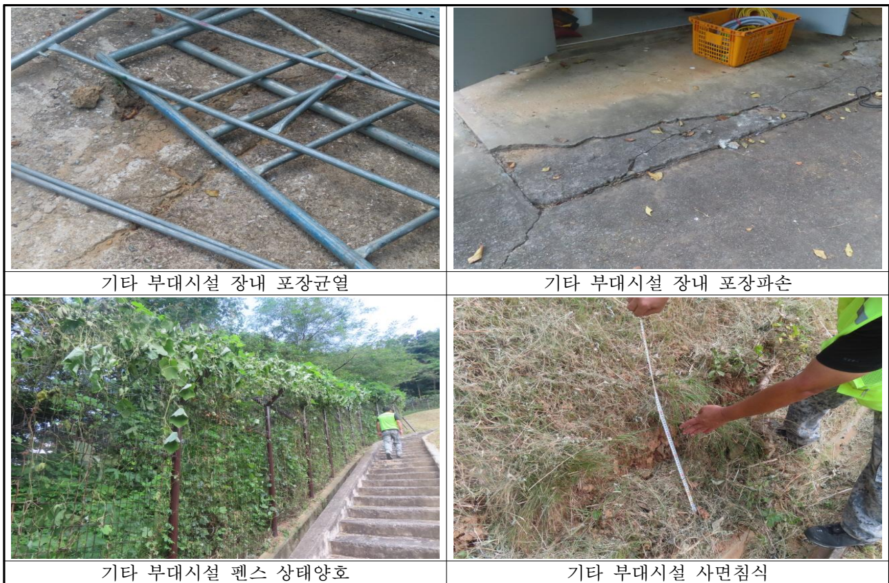
【사진 3.9】 기타 부대시설 손상사진
