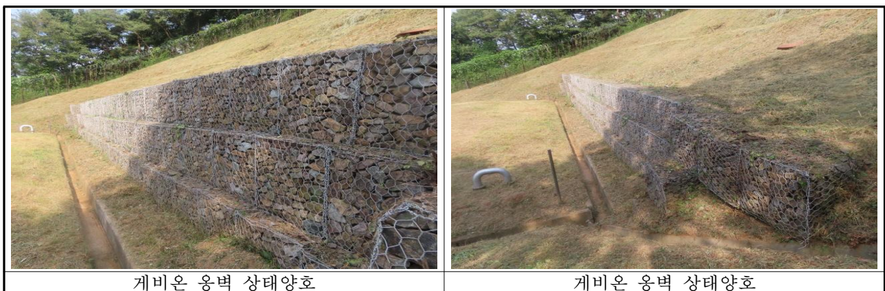
【사진 3.10】 옹벽 손상사진(계속)
